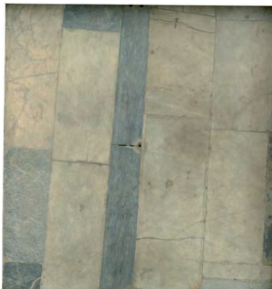
Abb. 7: Verteilerraum 36, Bodenbelag im Becken
